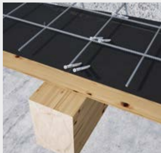
^ Kompozitna stropna plošča les-beton z razporeditvijo spojnikov pod kotom 30° v dveh vrstah.
